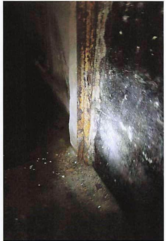
Der Keller steht ca. 0,40 m unter Wasser.
