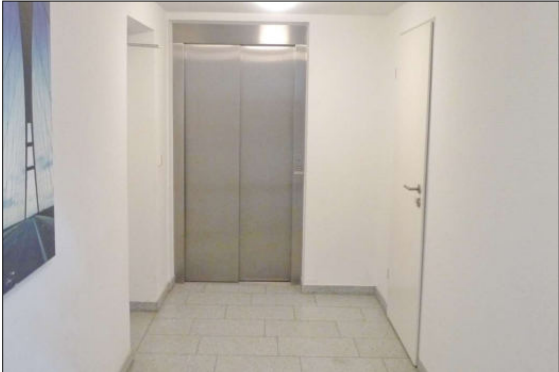
Abbildung 26 Tür zum Elektro-Raum ist keine baurechtlich geforderte FH-Tür fotografiert am 04.06.2025
