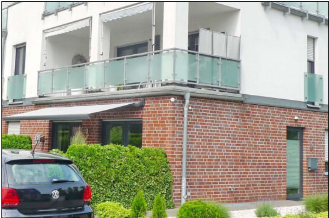
Abbildung 27 Feuchteerscheinungen im Klinkermauerwerk an der Südwestecke der Fassade, primär optischer Mangel fotografiert am 04.06.2025
