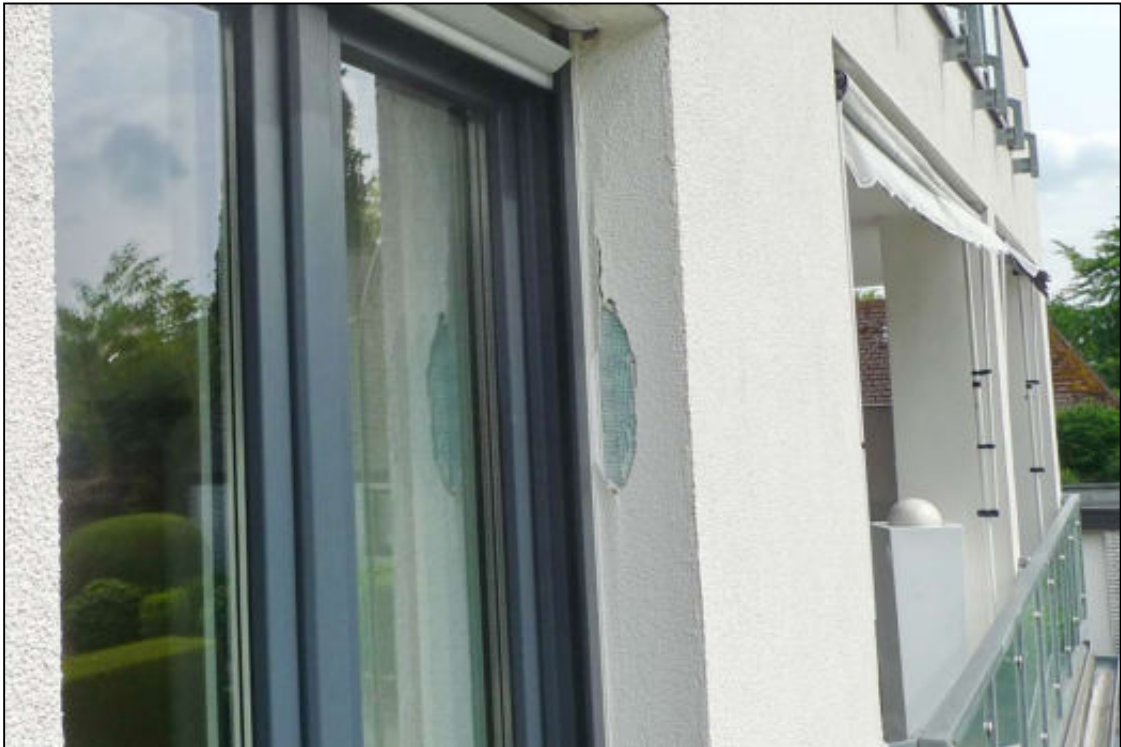
Abbildung 28 defekter Oberputz an der Fensterlaibung an der Westseite am Balkon der zu bewertenden Wohnung Nr. 6 im 1. Obergeschoss fotografiert am 04.06.2025
