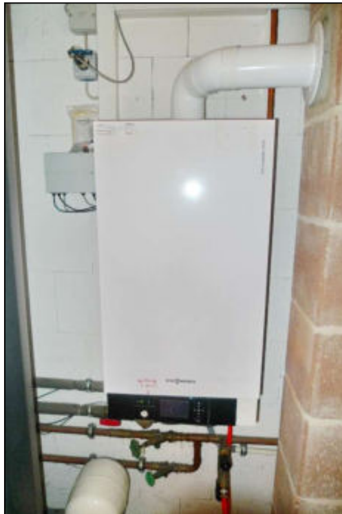
Abbildung 15 Heizungsanlage im Kellergeschoss fotografiert am 04.06.2025
