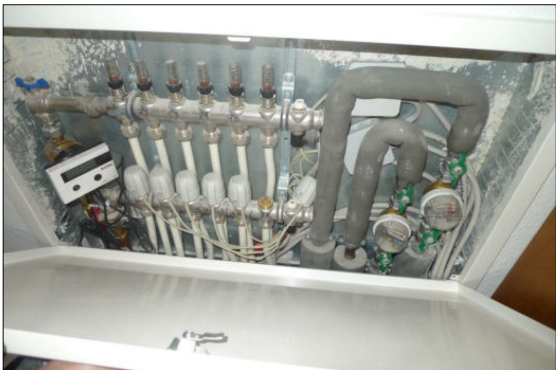
Abbildung 40 Fußbodenheizungsverteiler der Wohnung Nr. 6 fotografiert am 04.06.2025
