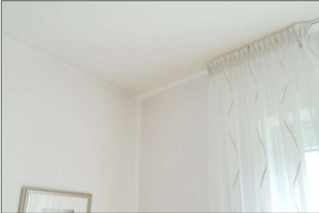
Abbildung 30 Feuchtigkeitserscheinungen an der Wohnzimmeraußenwanddecke der zu bewertenden Wohnung Nr. 6 im 1. Obergeschoss fotografiert am 04.06.2025
