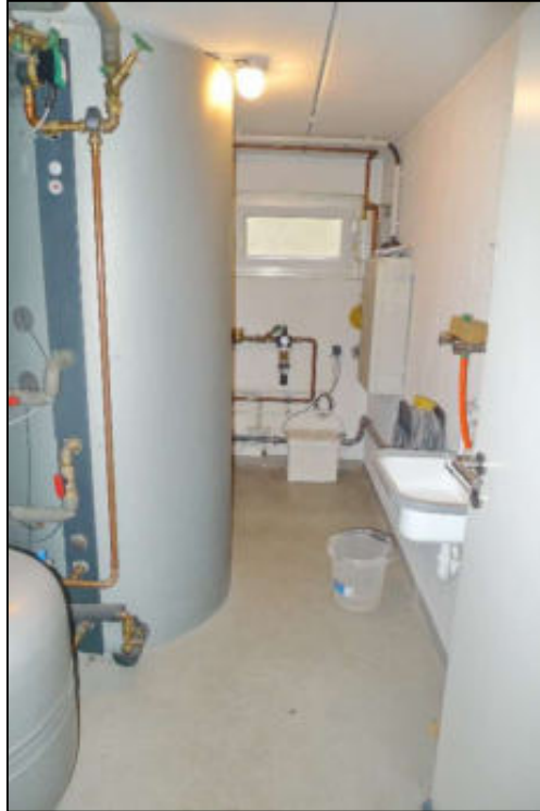
Abbildung 16 Heizungsraum im Kellergeschoss fotografiert am 04.06.2025
