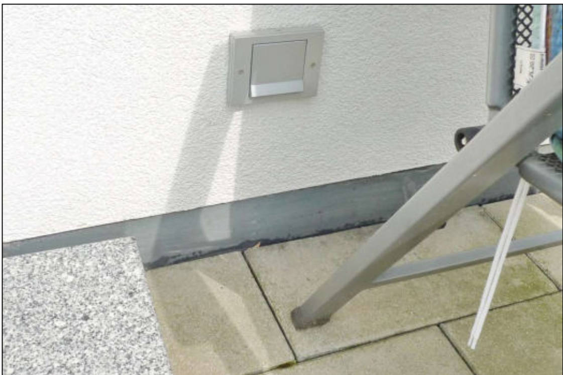
Abbildung 29 unzureichend an der Wand hochgeführte Abdichtung am Balkon der zu bewertenden Wohnung Nr. 6 im 1. Obergeschoss fotografiert am 04.06.2025
