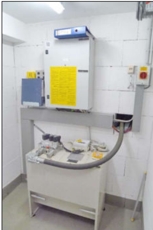
Abbildung 17 Aufzug-Maschinenraum im Kellergeschoss fotografiert am 04.06.2025
